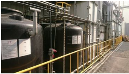
廢水處理系統
