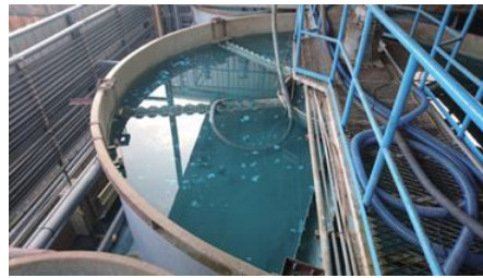
廢水處理系統
