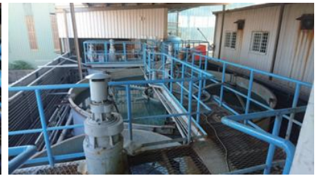
廢水處理系統
