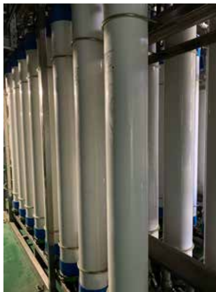
回收水RO膜管
