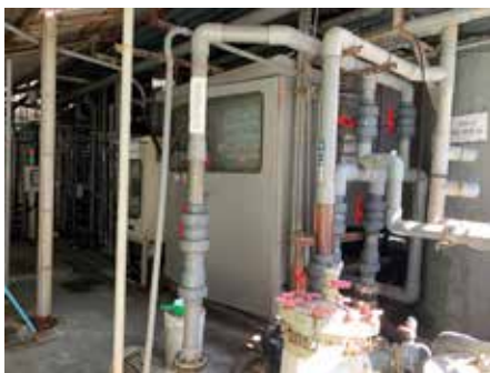
廢水處理系統
