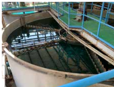
廢水處理系統
