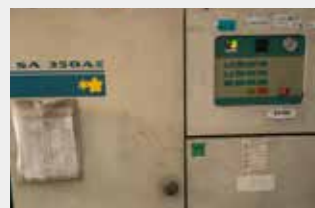
調降空壓系統供氣壓力以降低用電量
