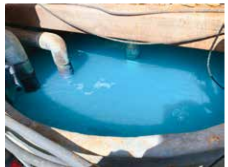
廢水處理系統
