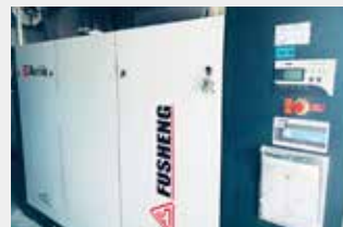
空壓機汰舊換新
