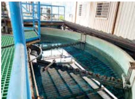
化學混凝沉澱池
