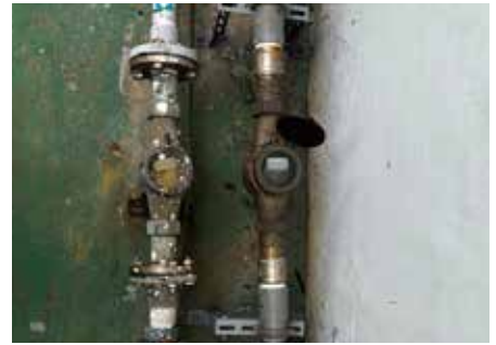
ROR回用洗滌/冷卻水塔之切換開關及計量設備
